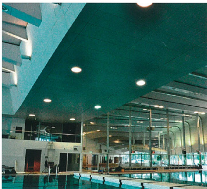
In het plafond zijn de installatieonderdelen met de armaturen voor lucht en licht opgenomen in ribben van waterbestendig mdf.
