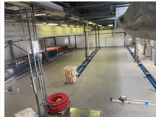
Drempels gemonteerd in een productiehal met heftruckverkeer
